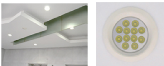
駒込データセンターのLED照明（左、右）
